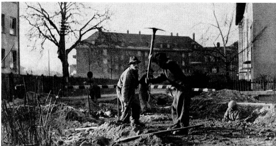
Auf dem Areal des Schweizerischen Roten Kreuzes auf dem Wankdorffeld, unmittelbar neben der Armeepotheke, rückten im Frühjahr 1953 die ersten Arbeiter an, um mit dem Bau des Blutspende-Zentrallaboratoriums zu beginnen.
