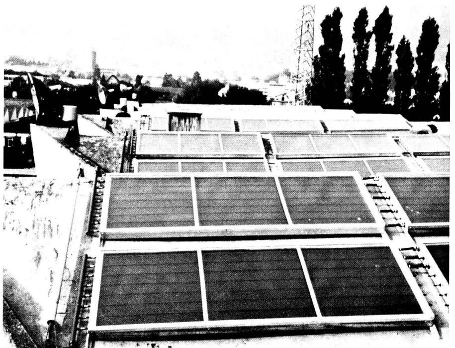
Flachkollektoren auf dem Tribürendach eines Stadions in Grenchen, die das Warmwasser für die Duschanlage aufbereiten. Gemäss verschiedenen Studien können pro Quadratmeter Sonnenkollektorfläche im Jahr mindestens 100 Liter Heizöl eingespart werden.
