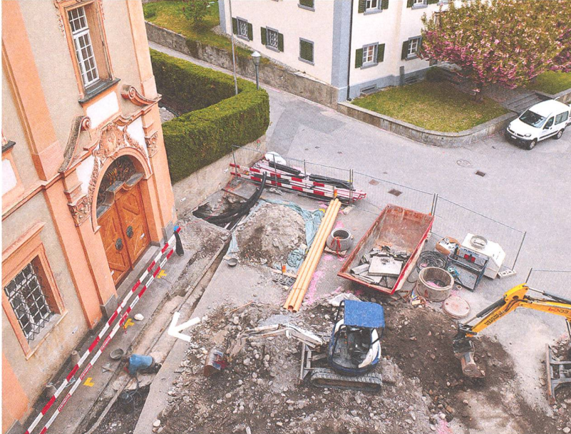
Abb. 2: Chur, Hof, Hofplatz Bischöfliches Schloss. 2013. Vor der Westfassade des Bischöflichen Schlosses ist das Fundament des gotischen Turmes (Pfeil) partiell freigelegt. Blick gegen Osten.
