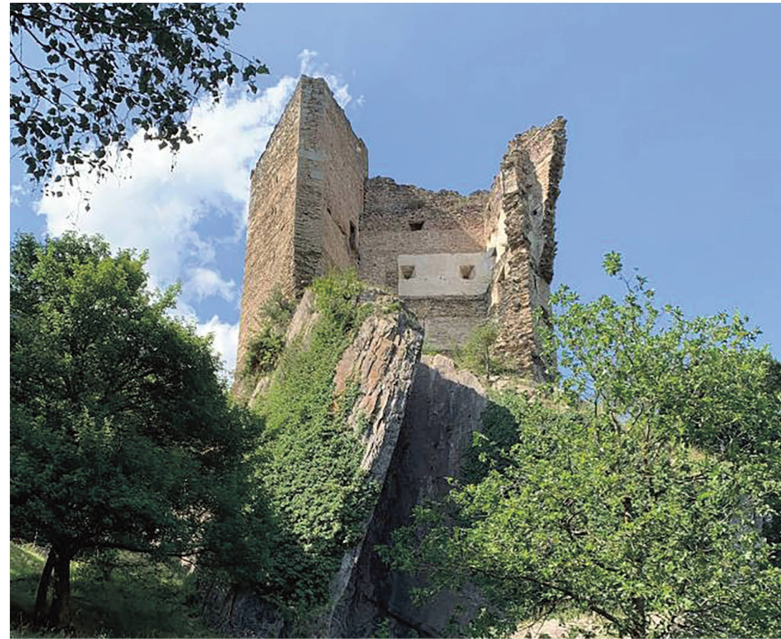
Abb. 3: Chur. Haldenstein, Burganlage Haldenstein. 2020/2021. Ansicht von Süden im August 2019 vor der ersten Konservierung. Anlass für die Konservierung 2020/2021 gaben Steinschlag sowie Felsbewegungen, mehrere Risse und Schwächen der Fundamentzonen. Blick gegen Norden.
