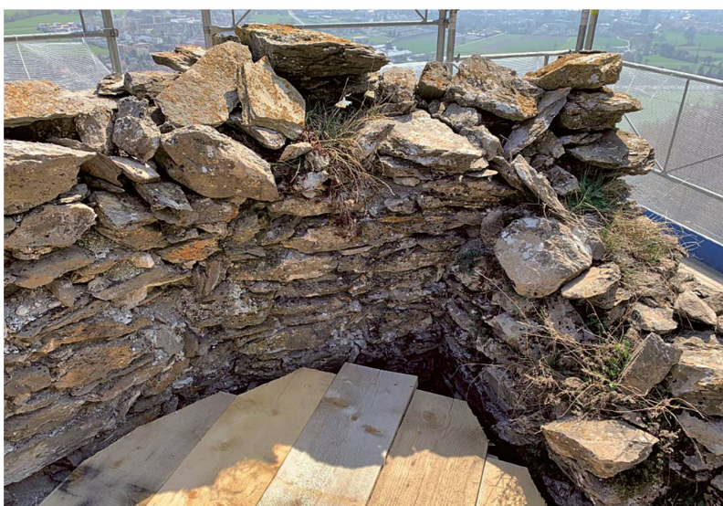
Abb. 5: Chur, Haldenstein, Burganlage Haldenstein. 2020/2021. Stark verwitterte Mauerkrone des Turms, aufgenommen im März 2020 anlässlich der Schadenkartierung ab Gerüst. Blick gegen Südosten.
