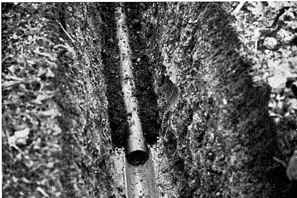
Canal formé de drains couchés dans la tranchée. On remarque la gorge qui forme l'assise, puis les tuyaux de terre et le remblai fait de terre perméable.
