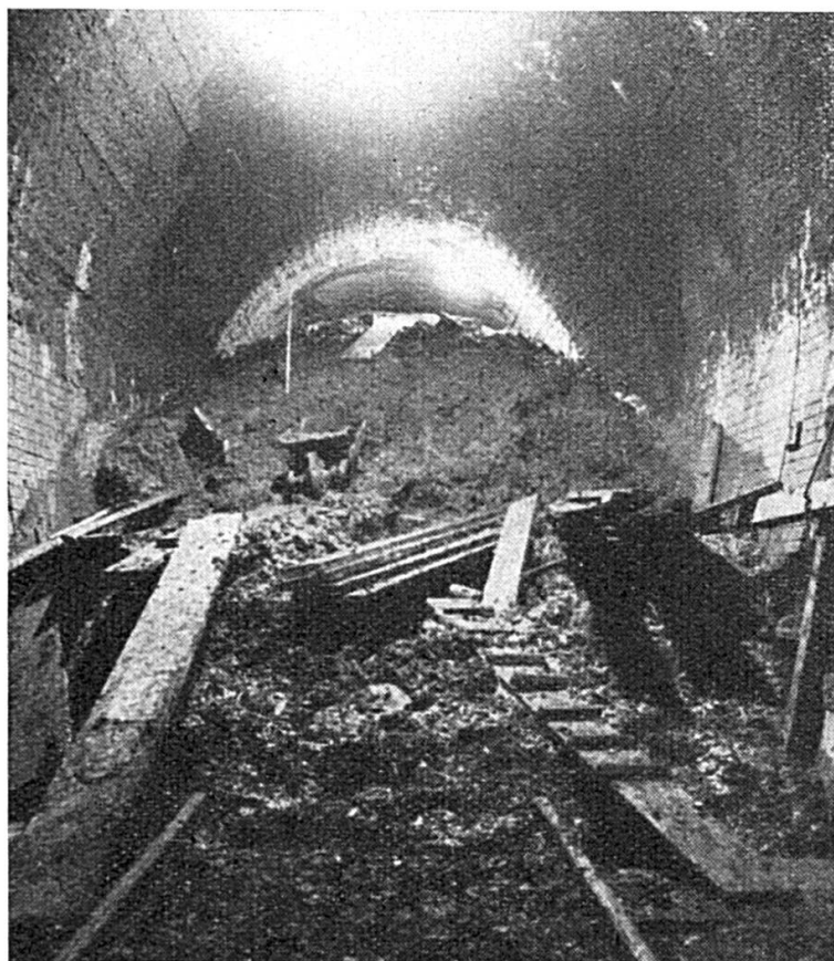
La masse de marne a envahi le tunnel.
