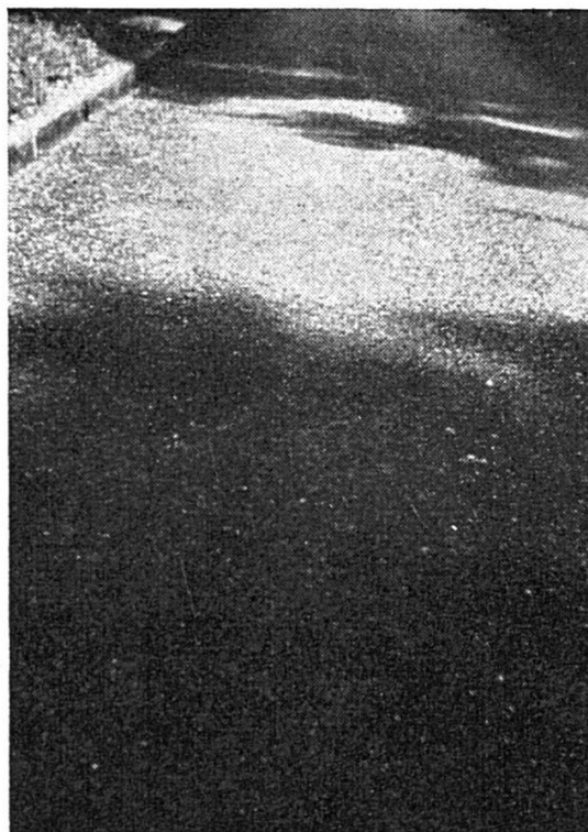
Bout d'essai, âgé de sept ans, construit selon système « Compactage aux Composols », pas d'usure, supporte une charge de 30 tonnes
