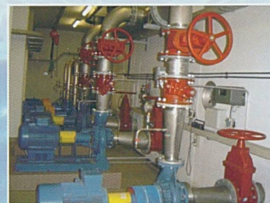
Traitement de l'eau potable
