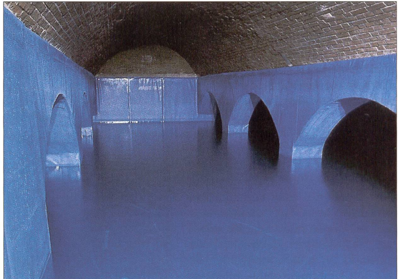
Réservoir d'eau potable (Photo eauservice, Ville de Lausanne)
