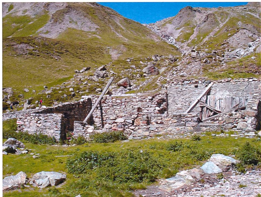
Abb. 4: Zerfallendes Gebäude des Oberstafels der Alp Valmala im Val d'Urezzas/Ardez, 2009 (Foto: B. Furrer).
