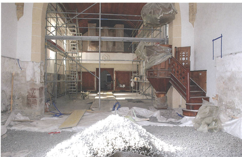
Abb. 6: Tamins, evangelisch-reformierte Kirche. Renovation 2010/11. Die Betonplatten links und rechts des Mittelgangs im Schiff sind gegossen. Im Chor wird die Dämmschicht aus Glasschaum (Misapor) aufgetragen, bevor der Betonguss folgt. Blick gegen Westen.
