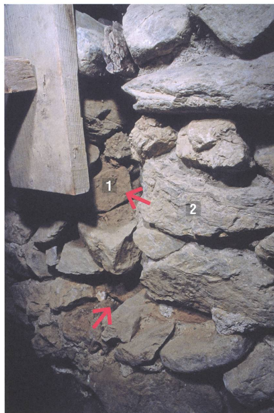
Abb. 173: Tomils, Sogn Murezi. Westannex, Raum F. Die Westmauer (536) mit 1 der Öffnung (1096). Gut zu erkennen ist das nördliche Gewände (Pfeile). 2 Zumauerung (1095). Blick nach Nordosten.
