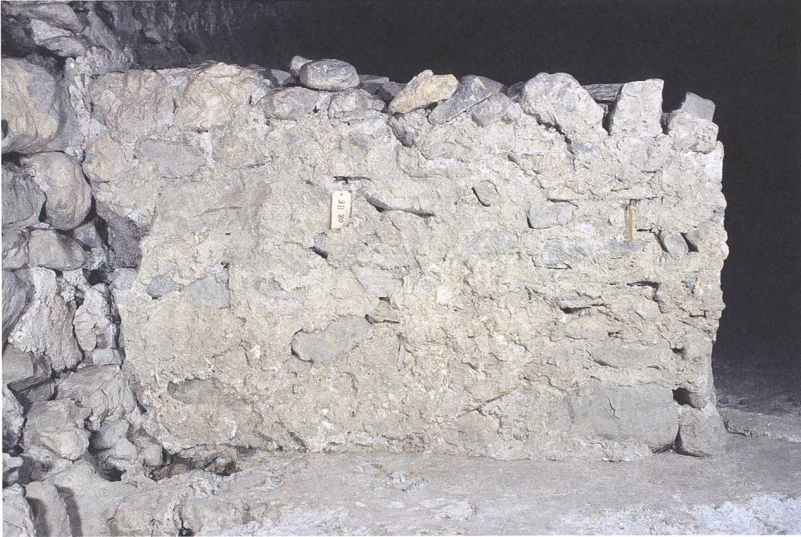
Abb. 325: Tomils, Sogn Murezi. Südannex E. Die Nordhälfte der Binnenmauer (1047). Blick nach Osten.
