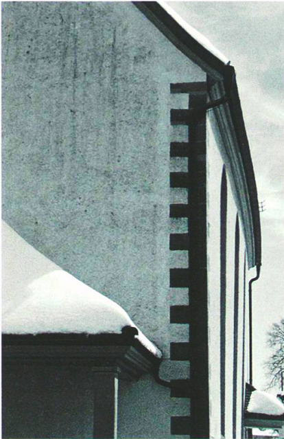
Abb. 10: Typisches Verformungsbild einer Kirchenwand: nachgiebige Wand, steife Ecken (Grub AR 2002).
