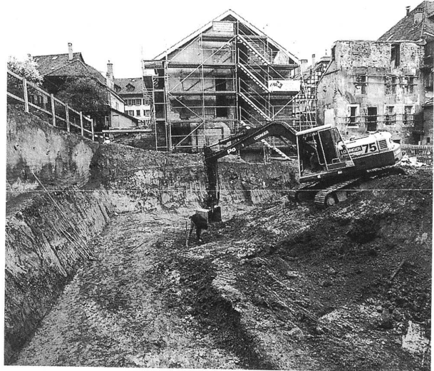
Abb. 1: Baugrube nach Westen mit Blick an die eingerüstete Ostfassade des ehem. Niederspitals.
