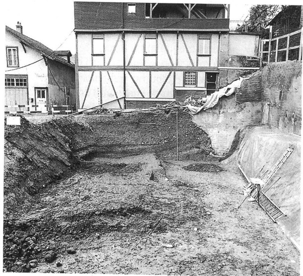
Abb. 2: Blick nach Osten in die offene Baugrube. Im Ostprofil sind deutlich die Kulturschichten erkennbar, welche vom jüngeren Stadtgraben durchschnitten wurden.
