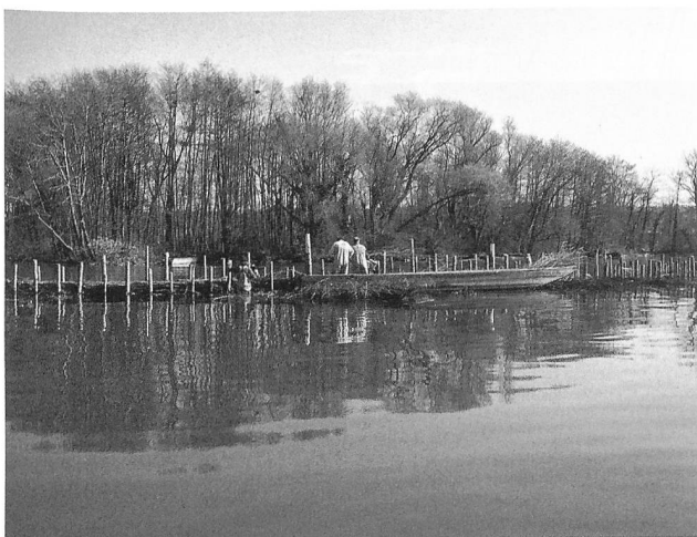
Abb. 60: Sutz-Lattrigen - Rütte 1998. Mitarbeiter des Arbeitswerks des Vereins Bielerseeschutz legen im Frühling Weidenfaschinen zwischen die doppelte Pfahlreihe der Lahnung ein. Blick nach Südosten.
