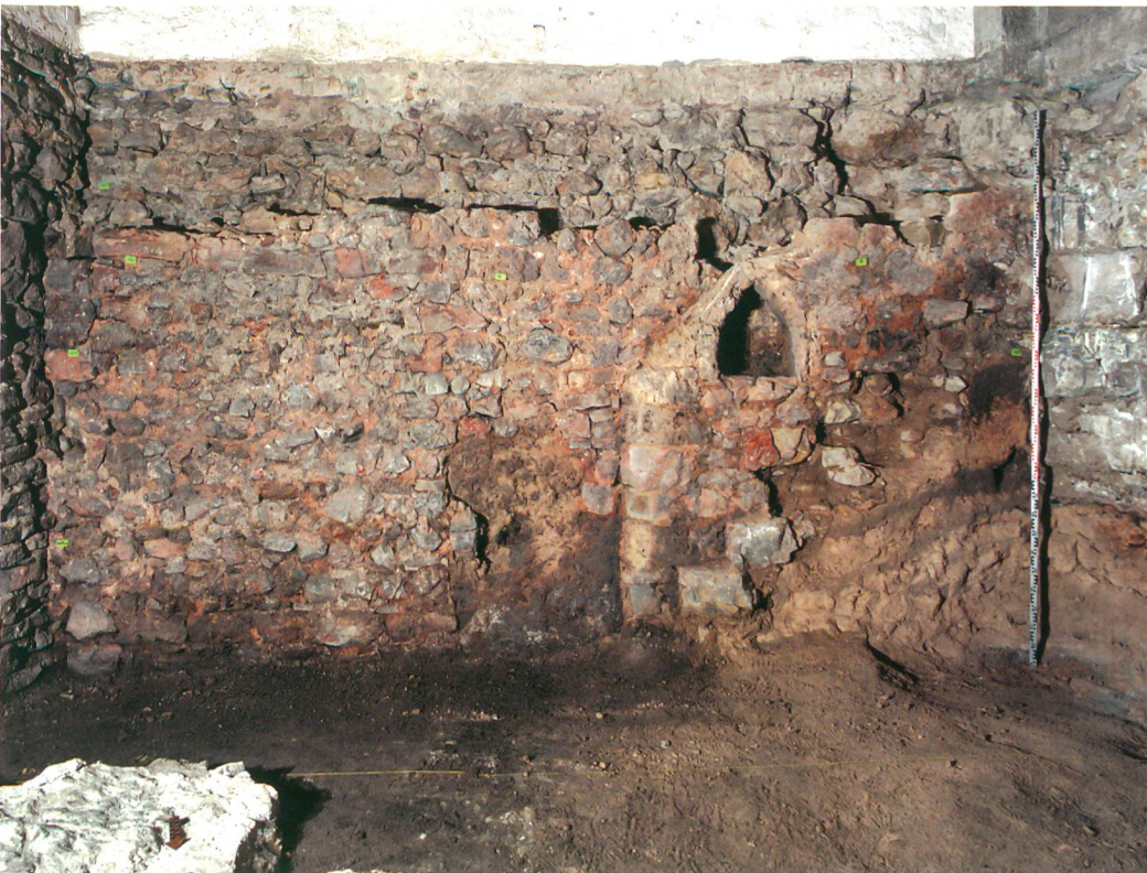
Abb. 4: Biel, Obergasse 4, Kellersüdwand. Ansicht der Mauern (3) / (9) während der Dokumentationsarbeit. Die Mauer (3) wurde der älteren Mauer (9) vorgeblendet. Der Verlauf der abgebrochenen Treppe von der Gasse her ist deutlich erkennbar. Die giebelartige Lichtnische diente zur Aufnahme eines Talglämpchens zur Beleuchtung. Der oberhalb der Treppe parallel verlaufende Vorsprung könnte ein Hinweis auf eine Holzterrasse sein, welche in den Raum über dem Keller führte.
