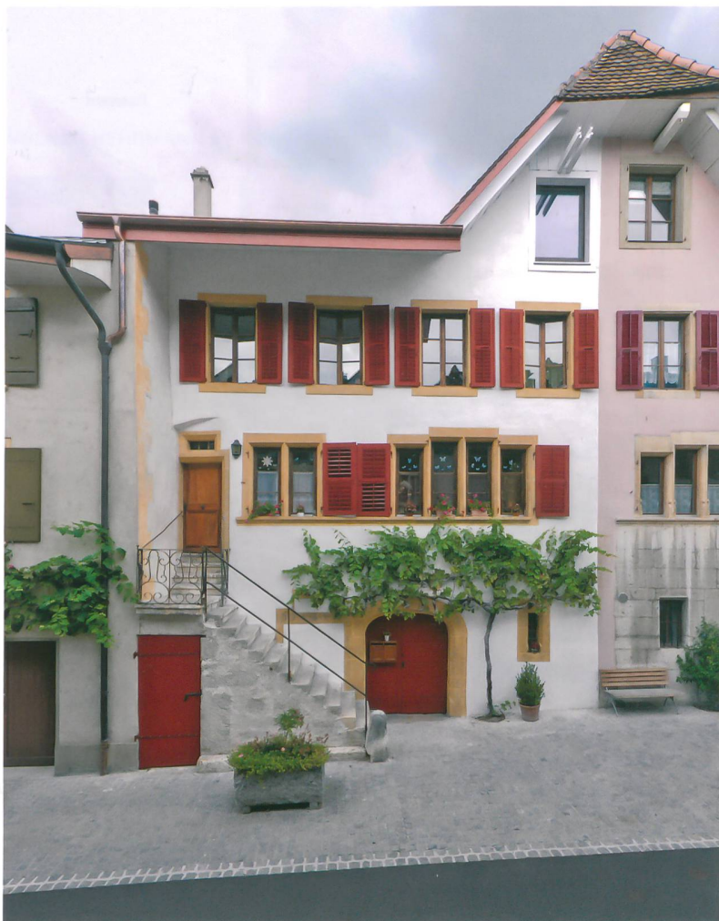
Fig. 4: La Neuveville, Rue du Faubourg 21-25. Façade sud restaurée avec une partie de la façade du bien voisin à l'est, réalisée par symétrie. Vue vers le nord.
