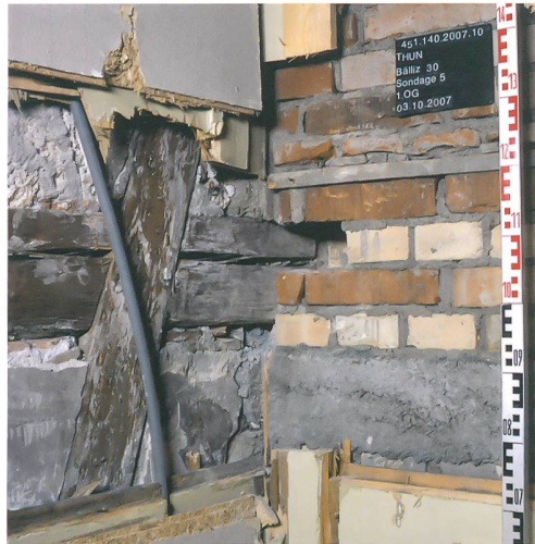
Abb. 27: Thun, Bälliz 30. Baunaht zwischen der nordwestlichen Fachwerkwand (38) des Hauses 5 (1825/33) und der Backsteinfassade, die nach 1885 entstand. Blick in die nordöstliche Hausecke des oberen Stockwerkes.
