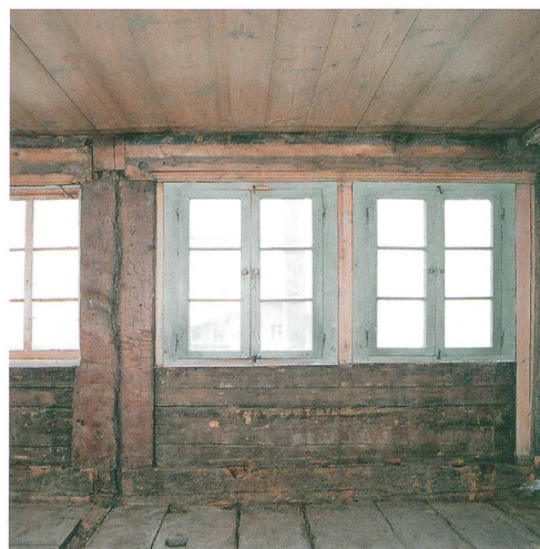
Abb. 11: Erlenbach, Ringoldingen, Heidenhaus. Links: Der Ständer in der linken Bildhälfte war ursprünglich der Eckständer der Trennwand zwischen Stube 2 und 3. In Bauphase III wird dieser Eckständer auf die Flucht der Südwand zurückgeschlagen. Am Deckenrähm ist die Profilierung zu sehen, die ohne Unterbruch ins rechte Bild läuft. Rechts: Die Profilierung endet beim Eckständer.
