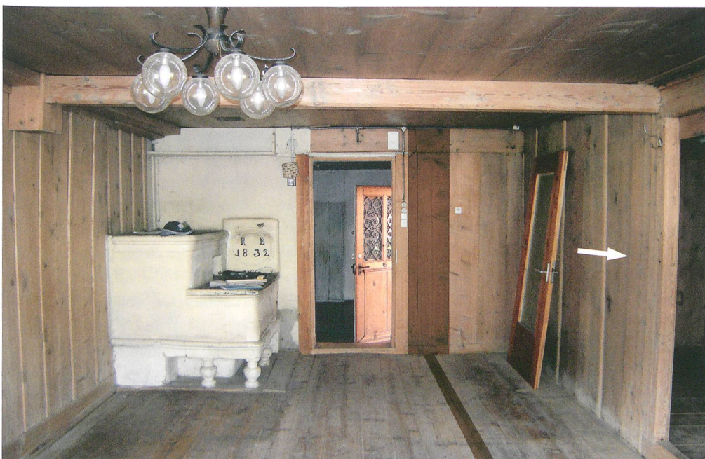
Abb. 27: Erlenbach, Ringoldingen, Heidenhaus. Zimmer 2. Die Ostwand der Bauphase III (weisser Pfeil) vergrösserte die Stube um einen Meter. In brauner Farbe ist auf dem Bild der Standort der Ostwand aus Bauphase I und II gekennzeichnet. Die Ofenplatte bezieht sich auf Rudolf Bächler, Besitzer des östlichen Hausteils von 1816 bis 1864. Blick nach Norden.
