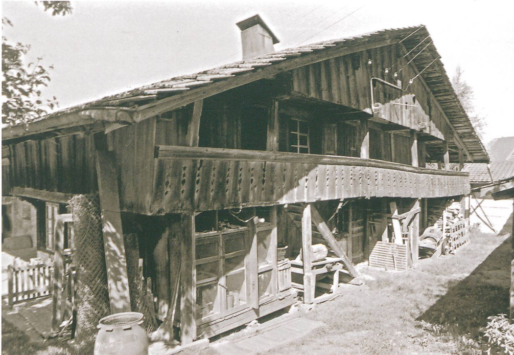
Abb. 25: Schwarzenburg, Junkerngasse 17, nordöstliche Fassade. Im Zuge des Umbaus von 1870 wurde der Wetterschild stark verkürzt. Die Giebel- laube stammt von einem älteren Haus und wurde gemeinsam mit den beiden Stuben eingebaut. Die verbretterte Fläche unter der linken Dach- traufe gehört zur 1870 entstandenen «Frucht- kiste». Rechts daneben der gleichzeitig einge- baute Gaden. Das Foto entstand 1993 und zeigt am rechten Bildrand den heute nicht mehr vorhan- denen Wagenschopf. Blick nach Nordwesten.
