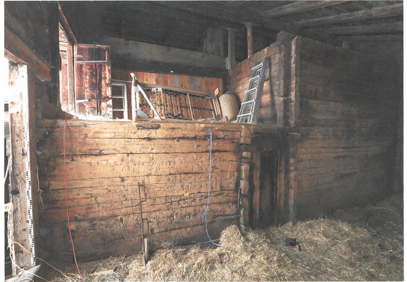
Abb. 7: Adelboden, Hirzbodenportstrasse 10. Blick in den Ökonombereich. Gut erkennbar ist die geschlossene Wohnkiste (rechts) sowie der der Ökonomie zugehörige Raum oberhalb der Küchenkammer. In der Bildmitte führt die Türe durch den Verbindungsgang zum Wohntrakt. Blick nach Süden.
