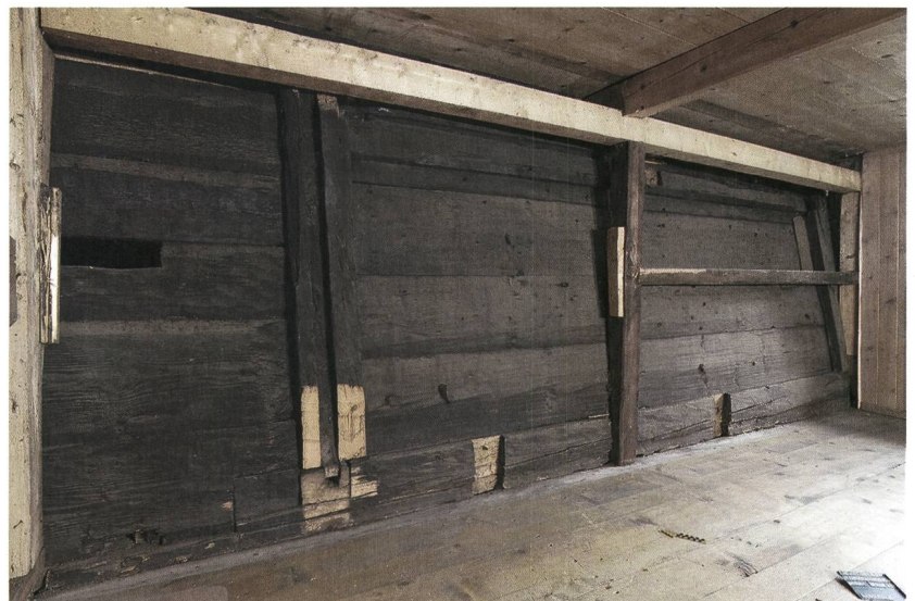
Abb. 18: Stocken-Höfen, Stockentalstrasse 33. Nördliche Gadenwand im Obergeschoss des Wohnhauses nach dem Entfernen des Täfers im Februar 2018. Blick nach Nordosten.
