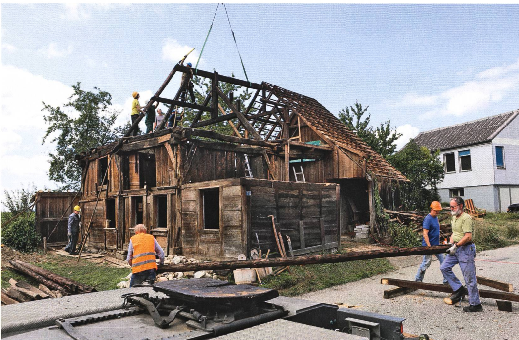
Abb. 5: Thunstetten, Kirchgasse 36: Das Taunerhaus während des Abbaus durch Freiwillige der Initiative für ein Aargauer Freilichtmuseum im August 2019. Blick von der Kirchgasse nach Nordwesten.
