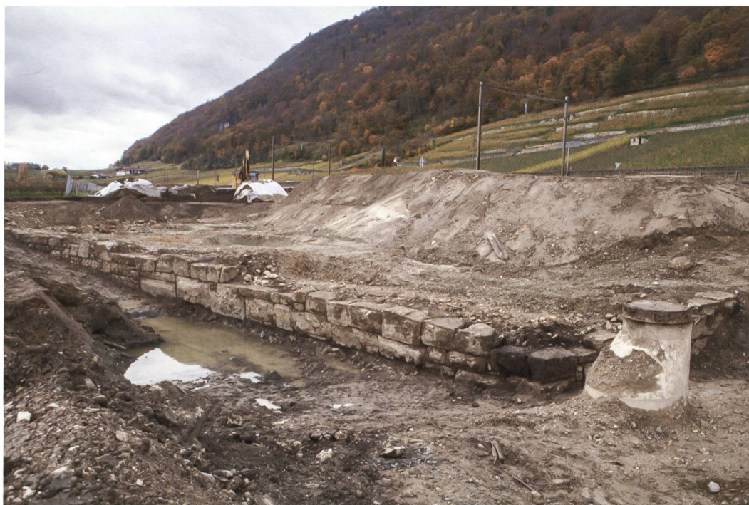
4 La Neuveville, Chavannes. Partie occidentale du mur du port réalisé en blocs calcaires dressés à joints vifs. À droite, derrière la chambre de ciment, amorce du débarcadère. Vue vers l'ouest.
