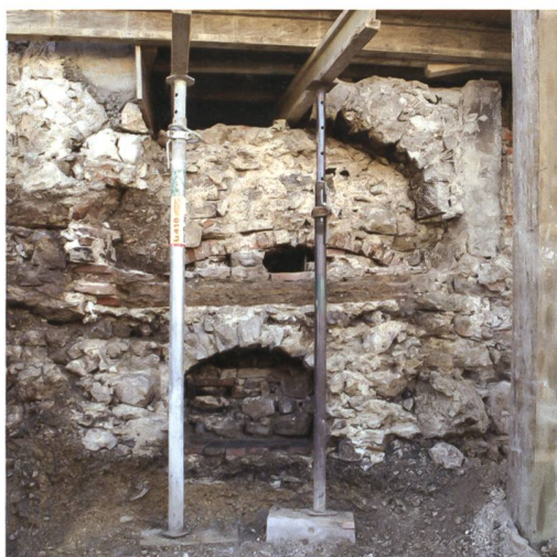
10 Sonceboz-Sombeval, Rue Pierre-Pertuis 1. Vue du four à pain (après démolition) au niveau de son insertion dans le mur est. Vue vers l'ouest depuis l'extérieur du bâtiment.
