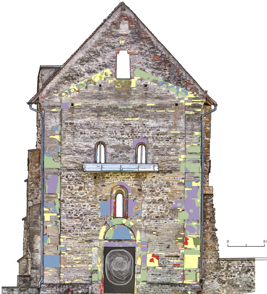
15 Rüeggisberg, Kloster. Nordfassade des Querhauses mit Kartierung der verschiedenen Schadentypen vor der Restaurierung. Planaufnahme von 2019. M. 1:100.
