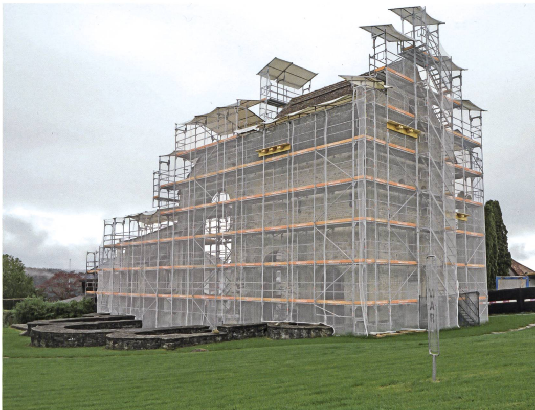
13 Rüeggisberg, Kloster. Nistkästen an den Gerüsten für die Mauersegler. Blick nach Südwesten. Aufnahme von 2020.
