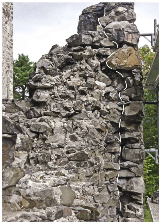
4 Frutigen, Tellenburg. Die Ablösung der Mauer- schale ist ein typisches Schadensbild. Durch die undichte Mauerkrone gelangte über Jahre Wasser in das Innere des Mauerwerks. Die in den Winterhalbjahren erfolgten Taufrostzyklen erzeugten Spannungen im Mauerwerk, welche den Mörtel auflösten und das Mauerwerk destabilisierten. Blick nach Osten. Aufnahme von 2016.
