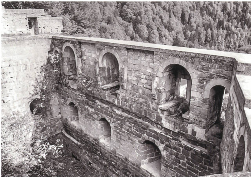
3 Schwarzenburg, Grasburg. Mauerkrone des Palas mit der Betonabdeckung der Restaurierung von 1928–1930. Blick nach Südosten. Aufnahme von 1961.
