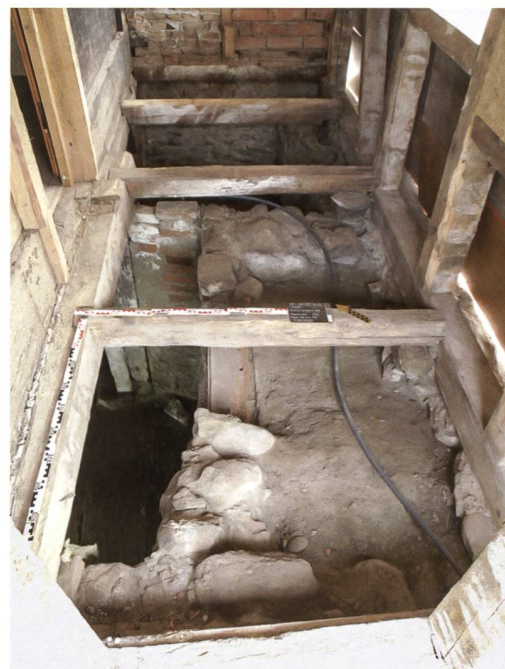
29 Thun, Schorenstrasse 40. Die Sondage V legte die Situation unter dem Fussboden des Raumes 4 frei. Die Backsteinmauer (117) steht auf der alten Kellertreppe (122) aus der Phase 3. Der dazugehörige Keller (Raum 2) reicht bis zum dritten Bodenbalken. Links zeigt sich das Flickmauerwerk (46) aus Phase 5. Von der Bildmitte bis zum Vordergrund zieht sich die versetzte Südostmauer (45) des Kellers (Raum 1). Zustand 2020.
