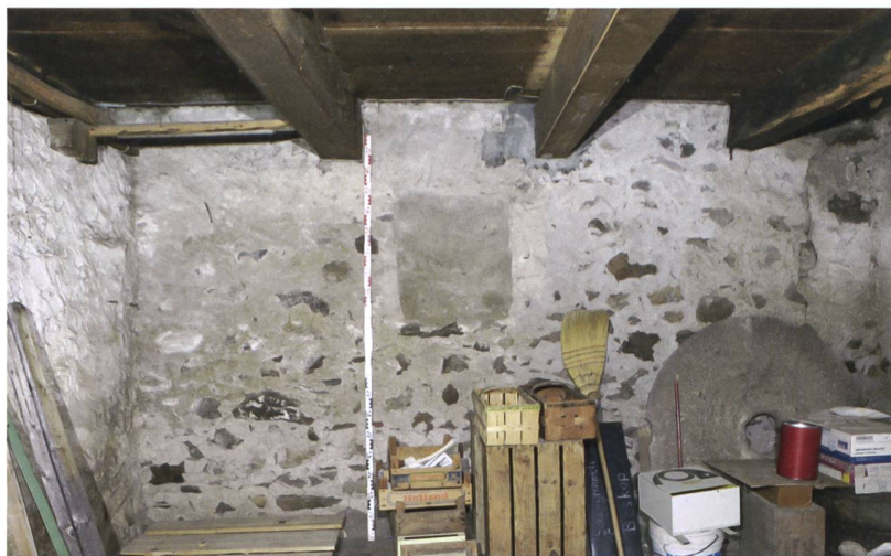
19 Thun, Schorenstrasse 40. Blick auf die nordöstliche Aussenwand (144) des Kellerstockes (Raum 11) mit der zugesetzten Lichtnische (148). Auf den Deckenbalken ruhen die Trägerbohlen eines Kalkgussbodens (147).
