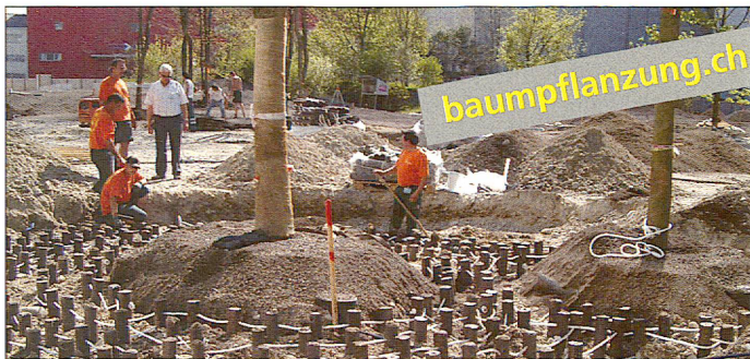
Wurzelanker für Grossbaumpflanzung auf Tiefgarage
