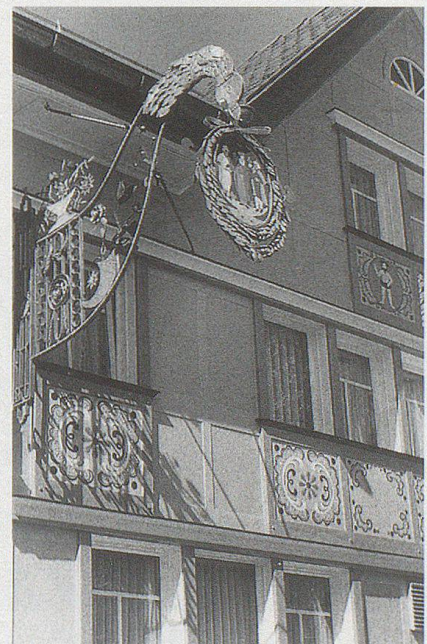
Zu den vorbildlich restaurierten Häusern im Dorf Oberegg gehört auch die Wirtschaft «Drei Könige».
