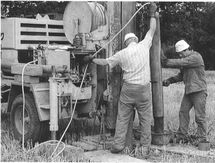
Abb. 4 Oben: Installierte Rammkernbohr- anlage im Einsatz. Unten: Das Auspressen des Bohrkernes aus der eingerammten Stahlhülse erfolgt mit Hilfe von Druckluft. Photos G. Sandoz. L'installation de forage employée à Augst. L'impianto per le trivellazioni stratigrafiche utilizzato ad Augst.
