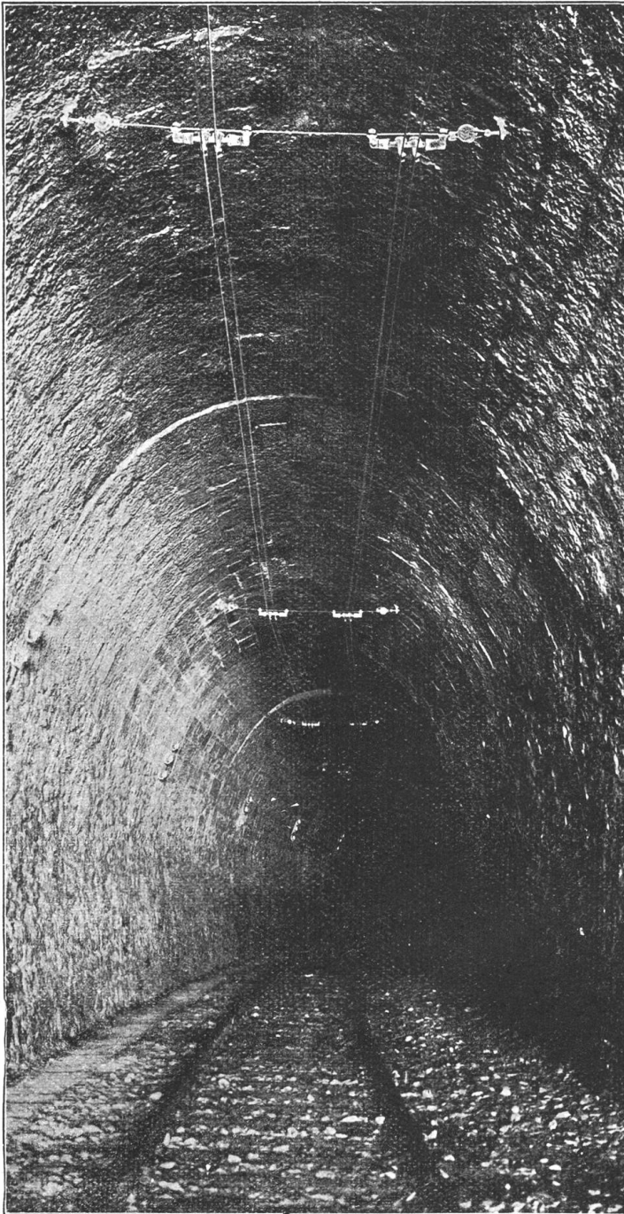
Abb. 14. Anordnung der Kontaktleitung im Tunnel.
