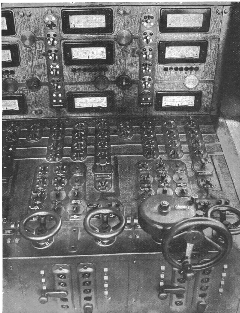
Fig. 31. Schaltbühne: Blick auf das Generatorenschaltpult.
