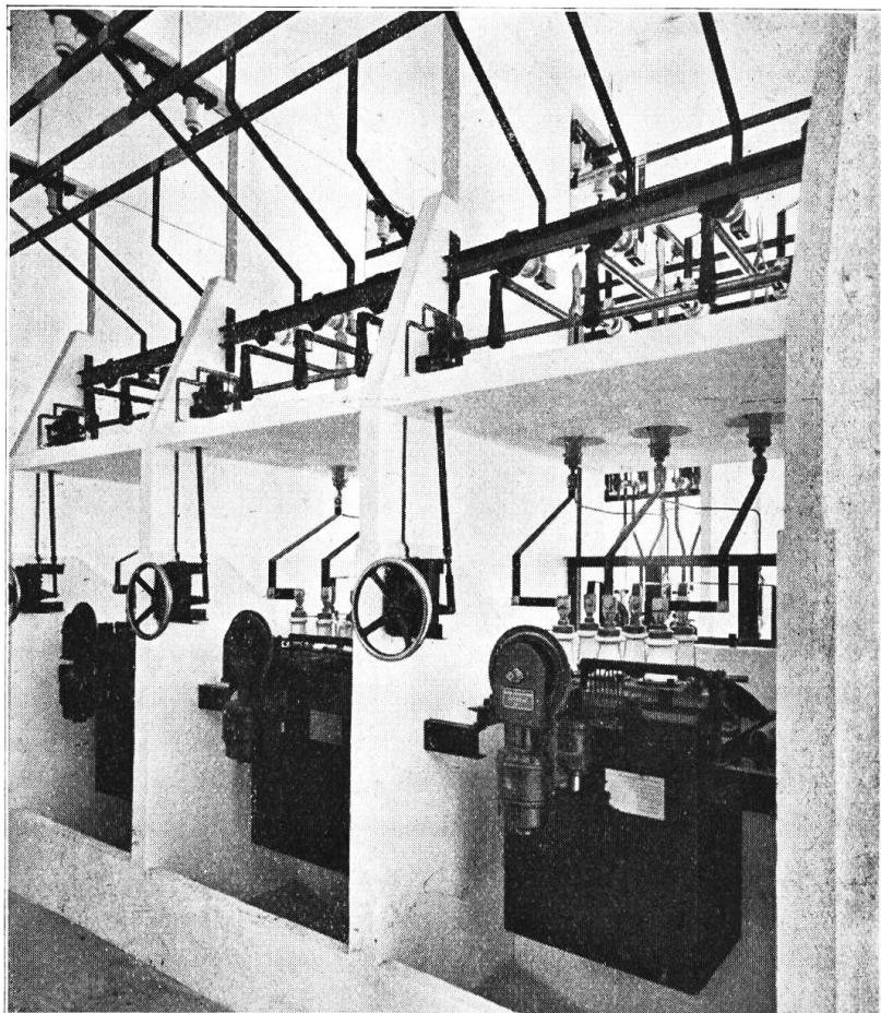
Fig. 25. Disjoncteurs automatiques des alternateurs.
