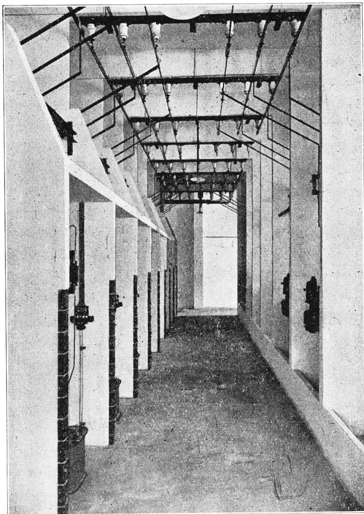
Fig. 22. Barres collectrices à 5600 volts.
