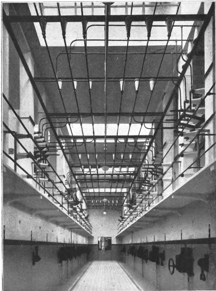
Fig. 11. Poste de Montcherand. Vue du couloir central.
