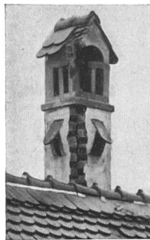
Fig. 23. Cas 127—32, Schwarzenburg, la cheminée endommagée.
