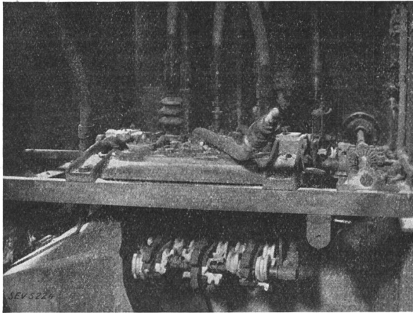
Fig. 3. Restes de l'interrupteur explosé, dans sa cellule.
