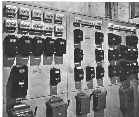
Fig. 5. Hauptverteiltafel für die Sektionen F G und J und Schalt- und Verteiltafel für die Sektion H.
