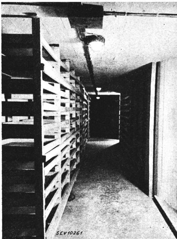
Fig. 1. Dörrhurden im Generatorabluftkanal.
