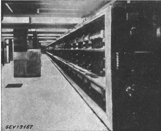
Fig. 20. Boulder Dam Sammelschienenraum.
