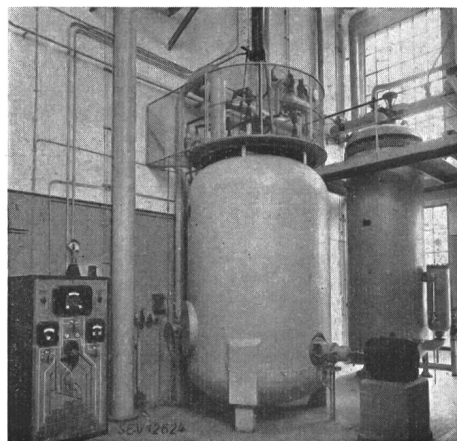
Fig. 1. Sulzer-Elektro-Heisswasserkessel 5000 kW, 6 kV, 13 kg/cm 2 Betriebsdruck, in einem Fernnetzwerk
