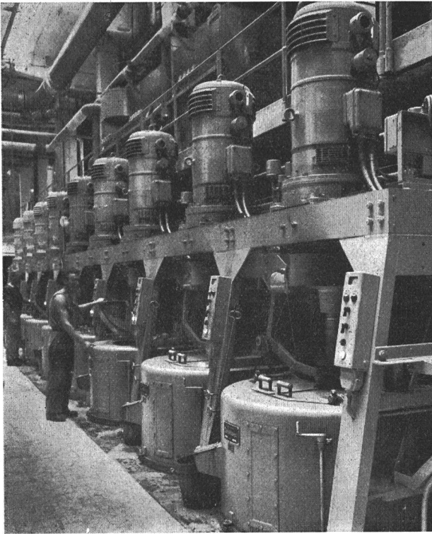
Fig. 2 Glasisolierte Hochleistungszentrifugen in der Zuckerfabrik Aarberg
