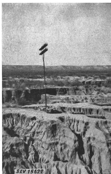
Fig. 8 Blick auf das Erosionsgebiet, über welches die Linie führt
