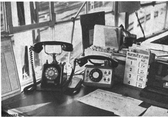
Fig. 5 Sprechstelle der Rangierfunkanlage auf dem Tisch des Aufsichtsbeamten im Hauptstellwerk Sprechstelle mit Betriebsanzeigelämpchen, Nummernscheibe und Fernschalter mit Kontrollampen für Sendevorheizung und Empfänger
