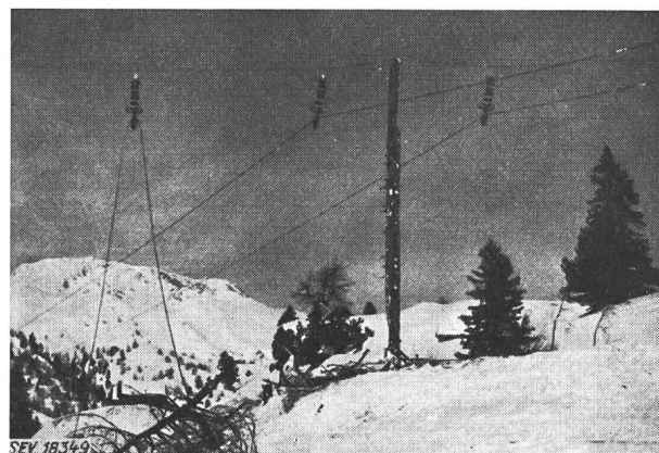
Fig. 8 Lukmanierleitung bei Acquacalda Provisorischer Stützpunkt mit Isolatorenketten an Tragseil
