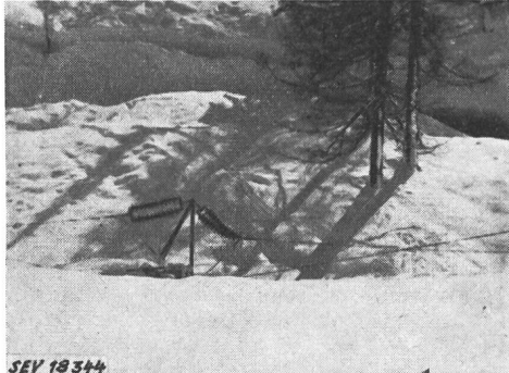
Fig. 3 150-kV-Nufenenleitung Lawinenschaden an einem Abspannmast
