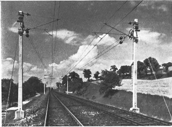
Fig. 3 Fahrleitung der Einheitsbauart der ÖBB Strecke Linz—Amstetten
