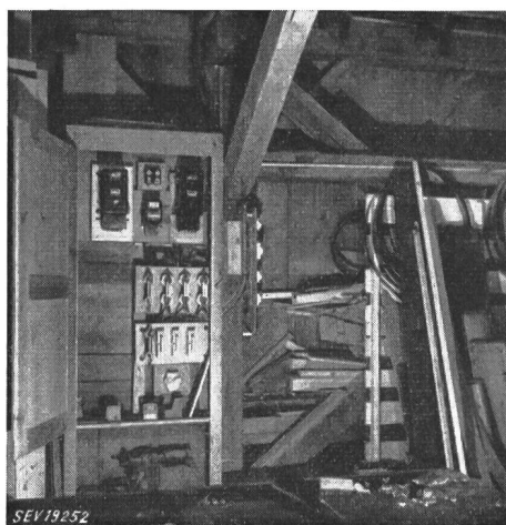
Fig. 41 Ancienne installation de coupe-circuit et de mesure d'une menuiserie
