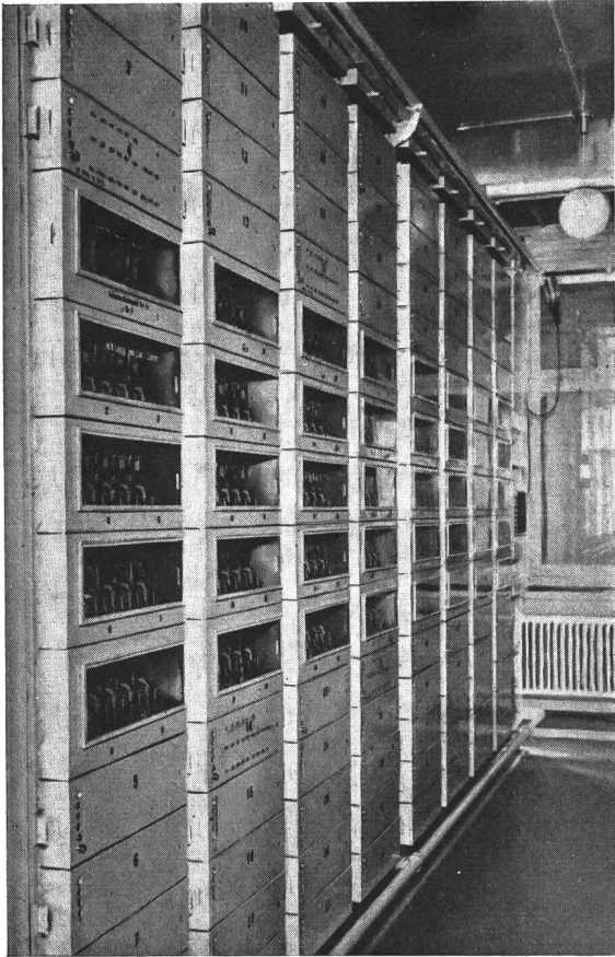
Fig. 5 Gestellreihe mit wählenden Verbindungsleitungen
