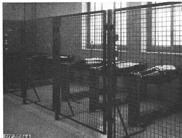
Fig. 14 Sechs Spannungswandler, Pol-Erde, 60 kV
