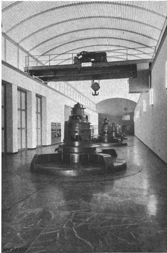
Fig. 7 Maschinenhaus Verbano Maschinensaal
